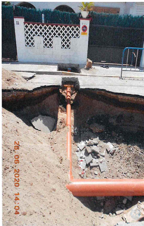
Foto nº 8. Carrer Vescomptes de Cabrera. Esllavissament de terres i paviment al fer la connexió de l'escomesa a la xarxa general.
