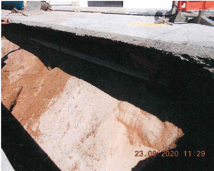
Foto nº 6. Carrer Vescomptes de Cabrera. Obra actual. Esllavissament de terres al fer excavació de rasa i xarxa d'aigua potable descalçada.
