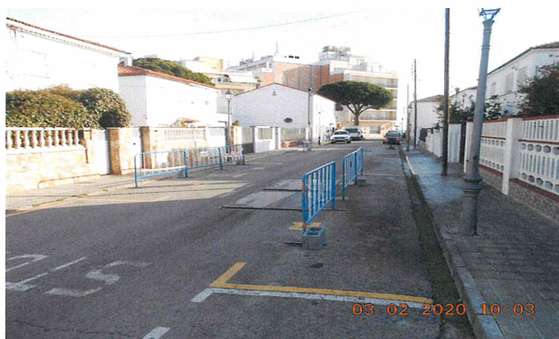
Foto nº 2. Carrer Vescomtes de Cabrera. Senyalització per protegir els trencaments de paviment.
