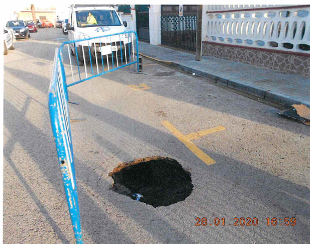
Foto nº 1. Carrer Vescomtes de Cabrera. Forat provocat per trencament de la xarxa de claveguera.
