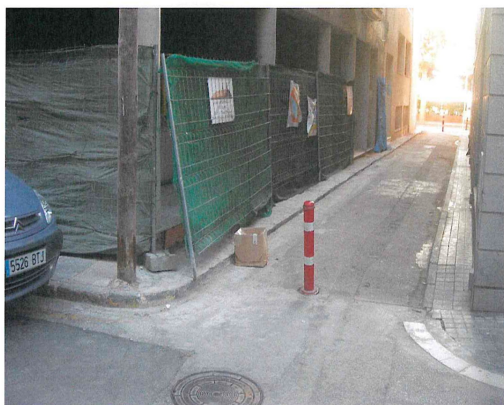
Foto nº 1. Punt de connexió amb el pou de clavegueram del C. Or amb C. Roig i Jalpí.
