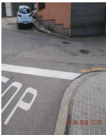
Foto nº 5. Carrer Mas Palou. Punt de confluència i connexió amb c/ Vil·la de Lloret. Tapes existents dels serveis a renovar.
