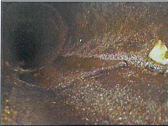
Fotografía: 20a, Nº Video: 0032, 00:06:17 16,7m, Grietas cruzadas desde 04 hasta 06 horas
