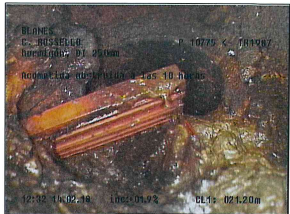
Fotografía: 21b, Nº Video: 0032, 00:06:57 21,2m, Acometida obstruida a las 10 horas
