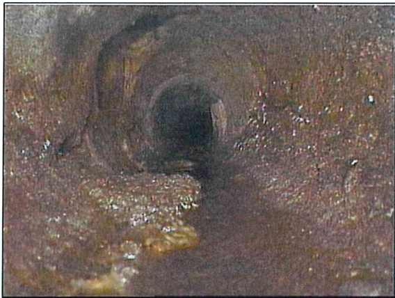
Fotografía: 10a, Nº Video: 0032, 00:01:43 6,2m, Roturas. Faltan trozos a las 08 horas
