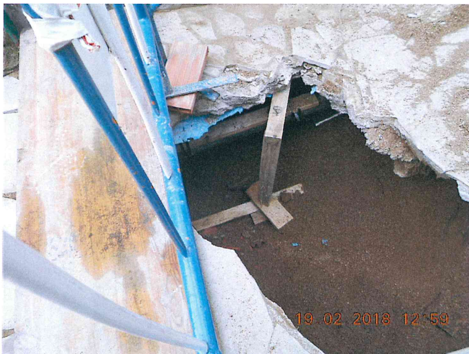
Foto nº 11. Enfonsament de la xarxa de clavegueram. Apuntalament del paviment.
