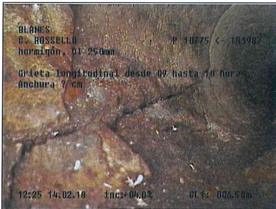
Fotografía: 12a, Nº Video: 0032, 00:02:25 6,6m, Grieta longitudinal desde 09 hasta 10 horas. Anchura ? cm
