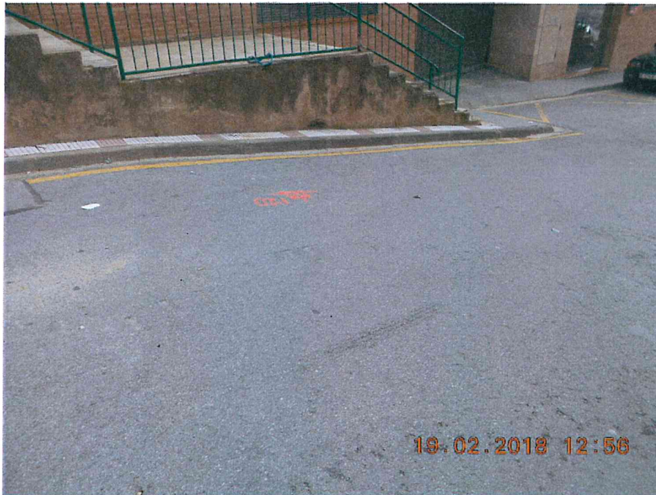
Foto nº 3. Carrer Rosselló xamfrà carrer Escalles de l'aigua. Pou ocult de clavegueram.
