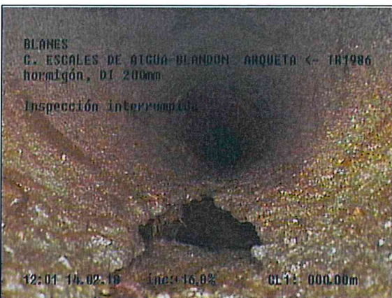
Fotografía: 7a, Nº Video: 0032, 00:04:46 2,3m, Inspección interrumpida
