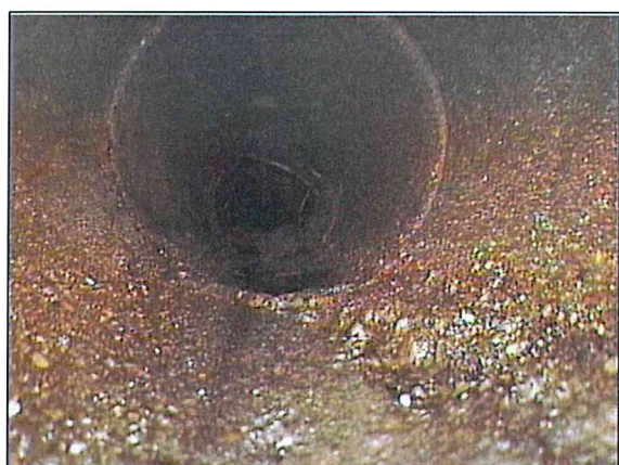
Fotografía: 4a, N° Video: 0032, 00:02:56 1m, Corrosión interior a las 06 horas
