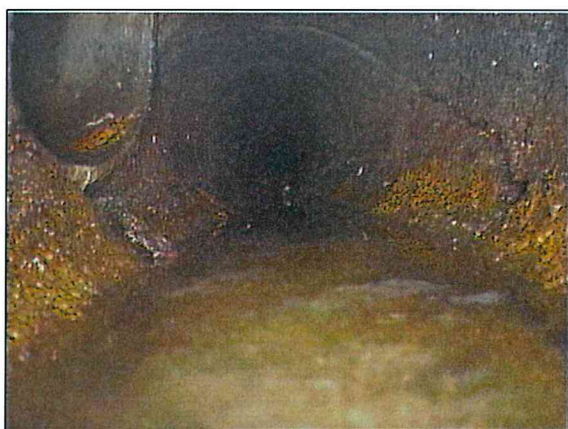
Fotografía: 17a, N° Video: 0032, 00:04:39 12,4m, Roturas. Faltan trozos desde 04 hasta 05 horas
