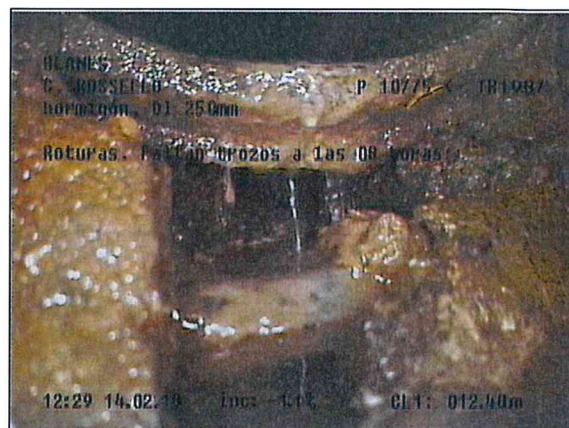
Fotografía: 18b, Nº Video: 0032, 00:05:00 12,4m, Roturas. Faltan trozos a las 08 horas
