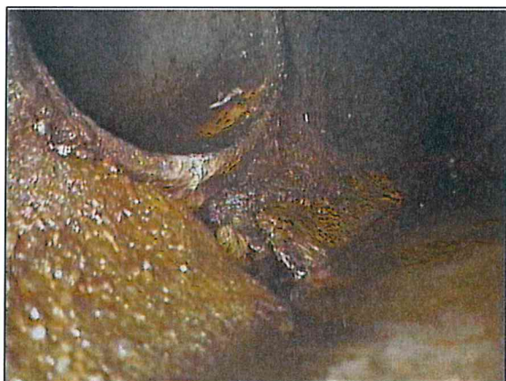
Fotografía: 18a, Nº Video: 0032, 00:05:00 12,4m, Roturas. Faltan trozos a las 08 horas
