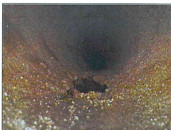
Fotografía: 5a, Nº Video: 0032, 00:03:41 2m, Roturas. Faltan trozos desde 05 hasta 07 horas, con filtración de agua
