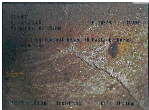
Fotografía: 15b, Nº Video: 0032, 00:03:49 11,1m, Grieta longitudinal desde 10 hasta 02 horas. Anchura ? cm
