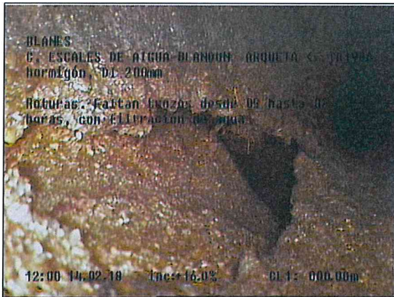
Fotografía: 5b, Nº Video: 0032, 00:03:41 2m, Roturas. Faltan trozos desde 05 hasta 07 horas, con filtración de agua
