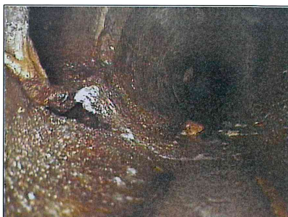
Fotografía: 26a, Nº Video: 0032, 00:09:45 31,1m, Roturas. Faltan trozos desde 07 hasta 08 horas
